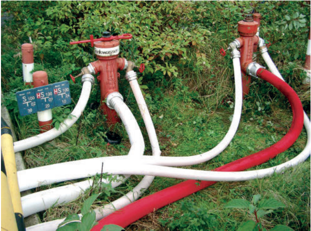
Bild 1: Auf diesem Bild sind zwei Überflurhydranten zu sehen, wovon einer an das öffentliche Trinkwassernetz (links, separat gekennzeichnet) und einer an das werkeigene Wassernetz angeschlossen ist.
